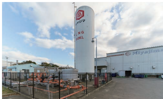
妙見工場 LNG貯蔵タンク
