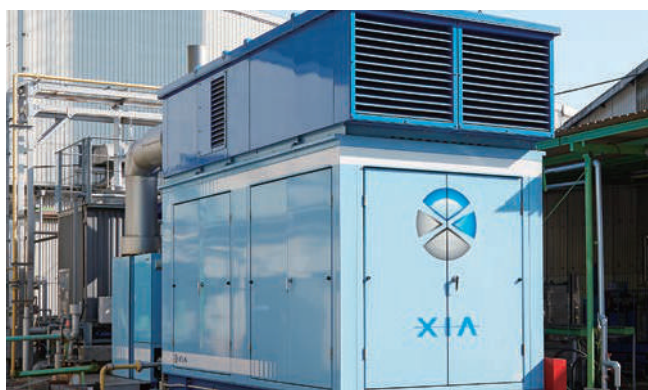
宇都宮工場 ガスコージェネレーション設備
