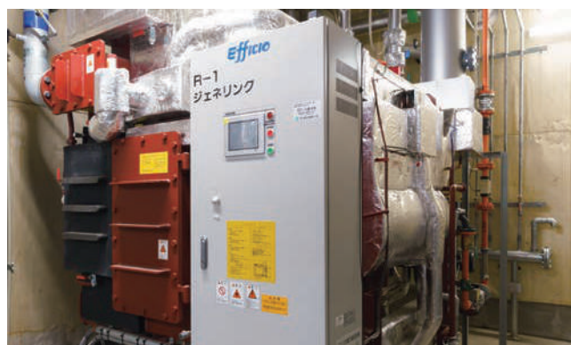
妙見工場 吸収式冷凍機
