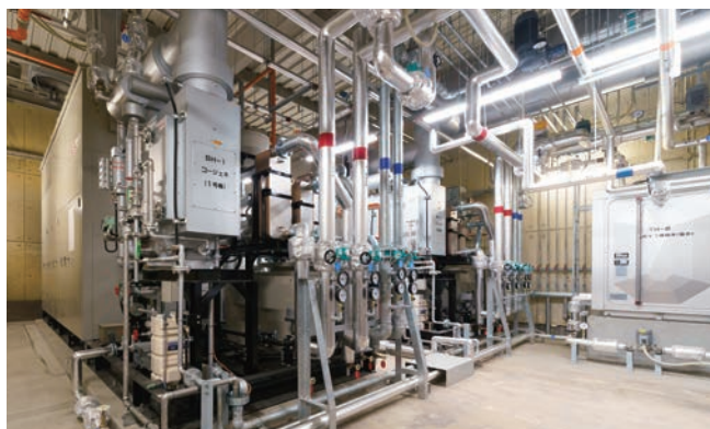
妙見工場 ガスコージェネレーション設備
