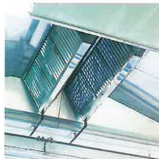
空調システム
