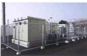
キュービクル受水槽
